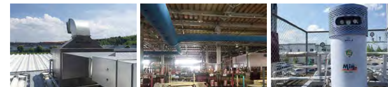
クライメイトウィザード 間接蒸発冷却システム「クライメイトウィザード」を工場に導入し省エネに貢献。 ダクトソックス 工場内に布製ダクトのダクトソックスが張り巡らされています。約10年間ノーメンテでも、全く問題ありません。 電気式ペーパーライザー ペーパーライザーをボイラー式から電気式に置き換えて、省エネ&省スペースで安全。
