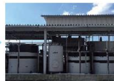
工場内排水処理施設
