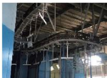
塗装表面処理排水
