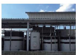
工場内排水処理施設
