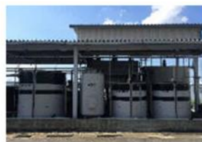
工場内排水処理施設
